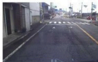
損傷レベル中
