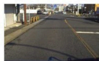
損傷レベル大
